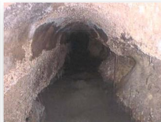
Effondrement Ovoïde (SPL eau des collines)
