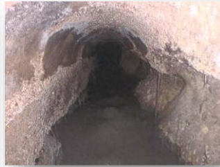
Effondrement Ovoïde (SPL eau des collines)
