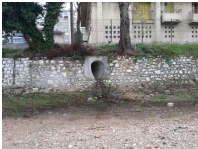
Figure 14: Exutoire d'un réseau pluvial - Marseille Ste Marguerite ©SIH
