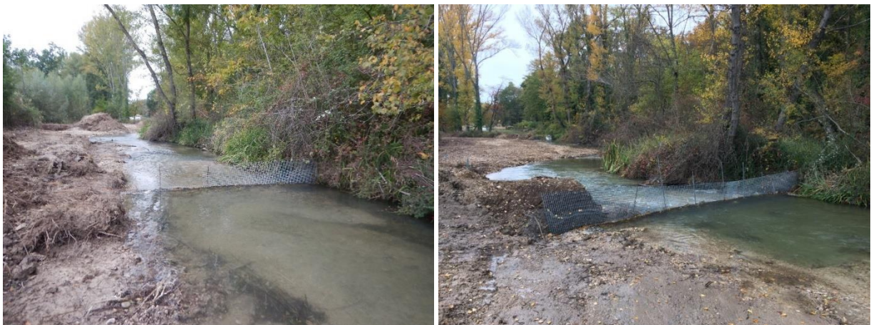
Dispositif de filtre anti-retour pour la faune piscicole sur tronçon pêché en préalable aux travaux de terrassements
