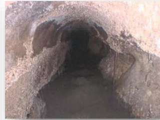
Effondrement Ovoïde (SPL eau des collines)
